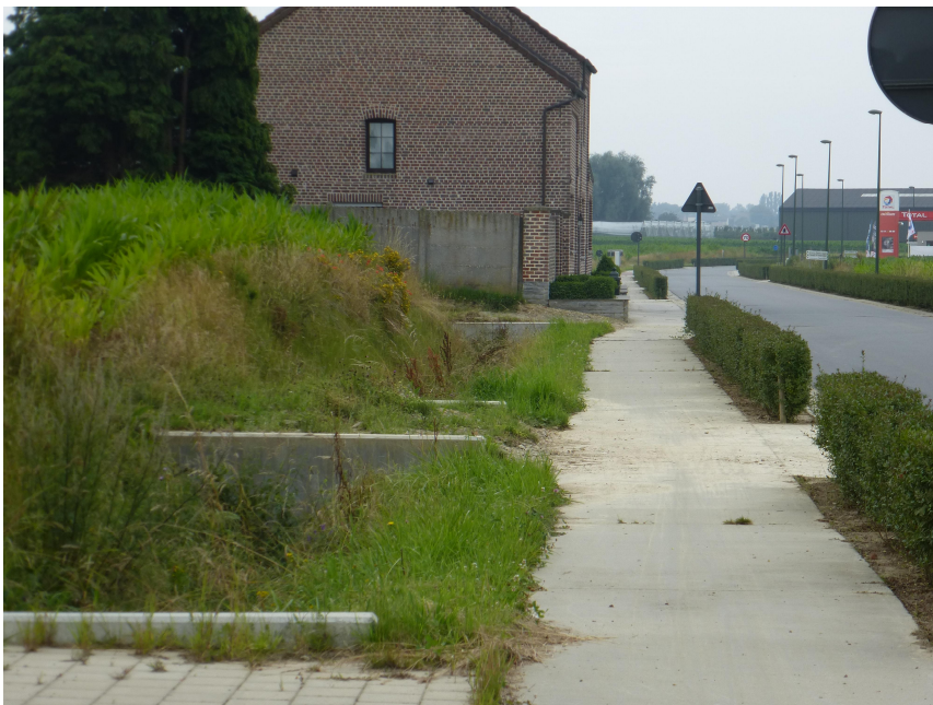
Foto 8: sedimentatie op fietspad ter hoogte van knelpunt 21.1
