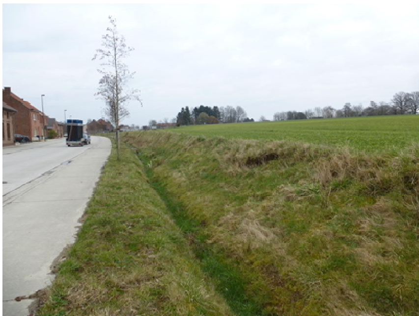
Foto 7: doorbraak in talud ter hoogte van knelpunt 21.1
