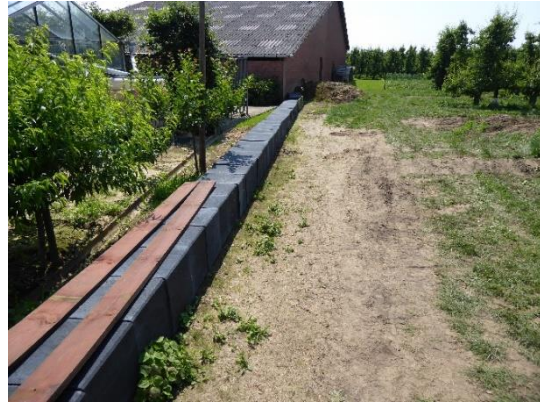
Foto 2.9.3.5-1: Constructie tegen erosie
