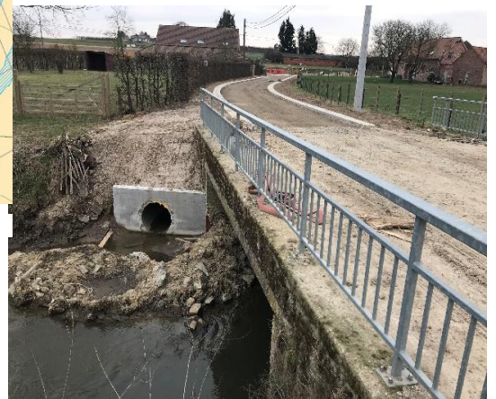
Foto 2.9.1.4-1: uitstroomconstructie in de Velpe
