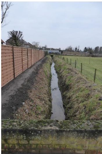
Foto 2.9.5.8-3: Waterloop t.h.v. Lindestraat
