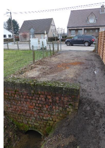
Foto 2.9.5.8-1: Waterloop t.h.v. Lindestraat
